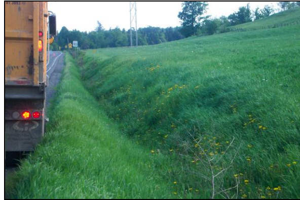
Figure 57 : Pente de moyenne à forte du bassin de drainage du site n° 11. Pente orientée perpendiculairement au fossé (7 juin 2005)
