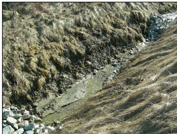
Figure 89 : Formation d'un méandre en amont d'un seuil et érosion par surcreusement localisé en aval du seuil n° 2 dans le fossé du site n° 5 (27 mars 2006)
