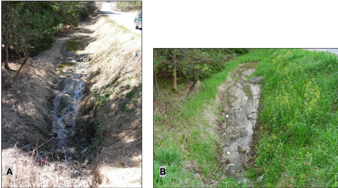
Figure 8 : Bassins de sédimentation en aval du site n° 7 : A) les bassins sont comblés à plus de 75 % (20 avril 2006); B) les bassins de sédimentation débordent (23 mai 2006)
