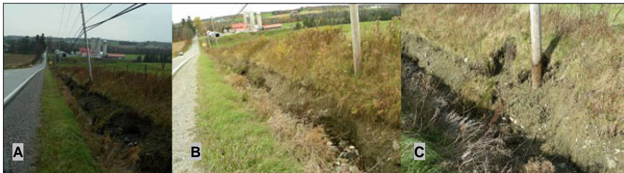
Figure 109 : Poteau d'Hydro-Québec penché de 10° à cause de l'érosion dans le fossé du site n° 10 : A) poteau au mètre 130 (31 octobre 2006); B) érosion à la base du poteau (17 octobre 2006); C) décrochement (1 er novembre 2006)
