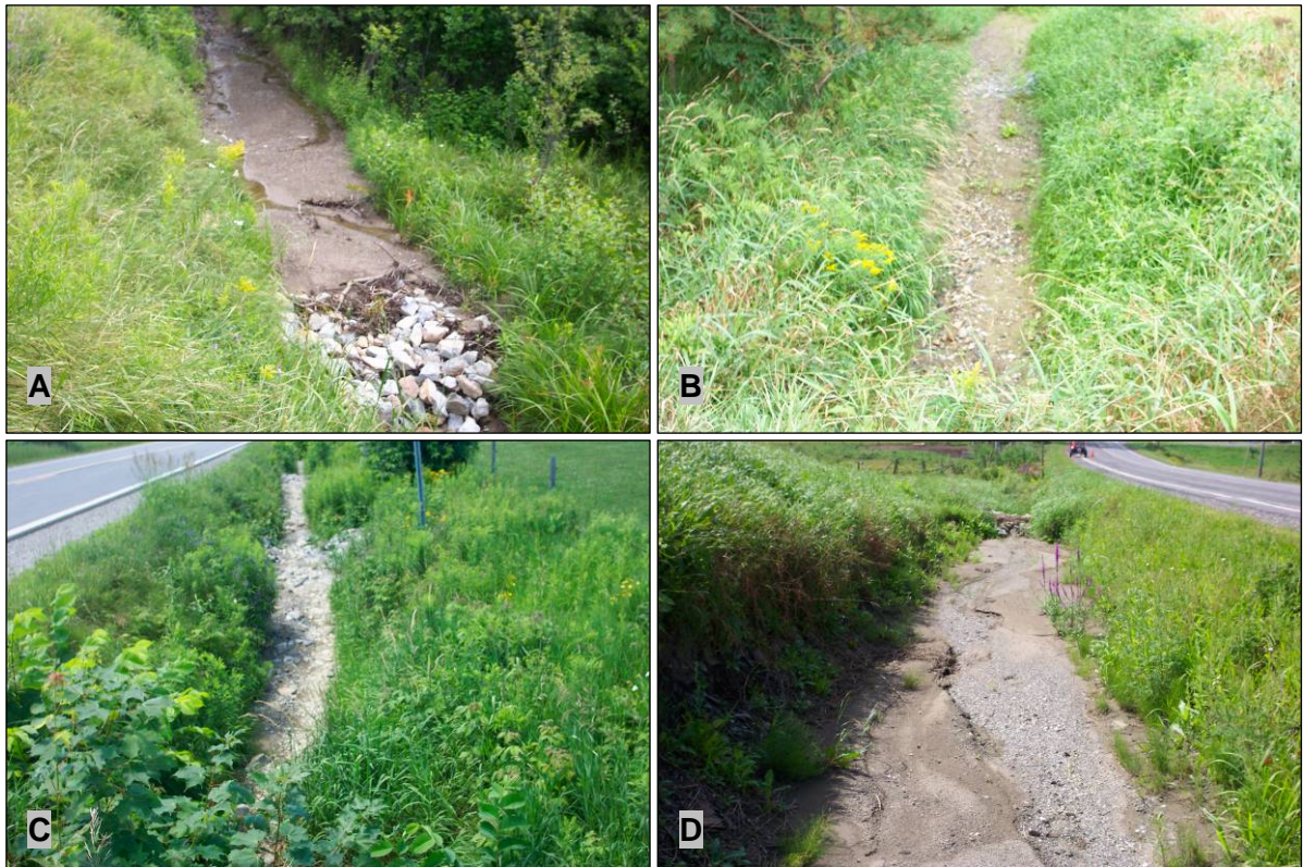
Figure 4 : État des bermes filtrantes avant le nettoyage : A) bassin de la berme du site n° 1 comblé de sédiments (26 juillet 2005); B) bassin de la berme du site n° 7 avant son nettoyage (15 août 2005); C) bermes vues de l'amont au site n° 10 (15 juillet 2005); D) bassin d'une berme avant nettoyage au site n° 11 (15 août 2005).
