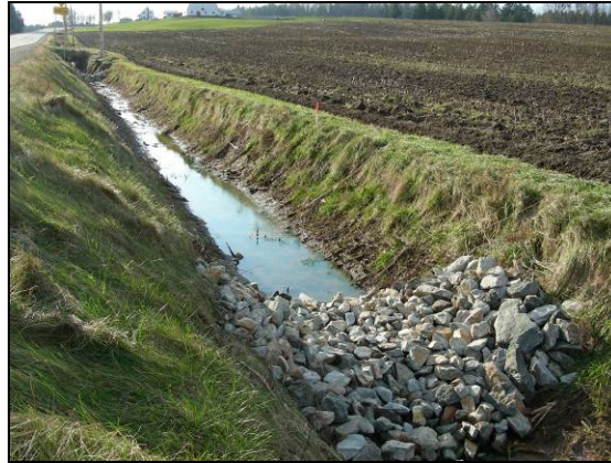
Figure 69 : Fossé de pente de moins de 3 % au site n° 14 entre les mètres 60 et 85 (21 novembre 2005)
