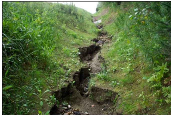
Figure 94 : Érosion régressive et latérale dans le fossé du site no 7 (15 août 2005)
