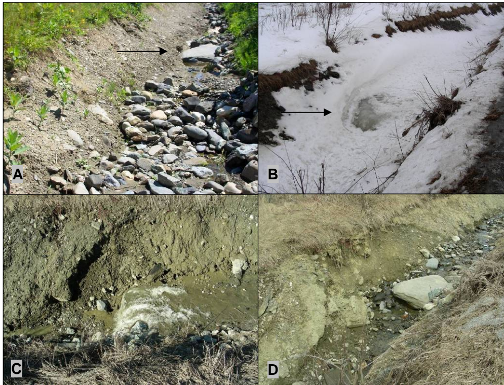
Figure 108 : Évolution de l'érosion au mètre 90 du fossé du site n° 10 : A) état de la situation le 15 juillet 2005 (15 juillet 2005); B) formation d'une couche de glace importante sur le bloc (10 mars 2006); C) déviation de l'écoulement vers le talus opposé à la route (27 mars 2006); D) érosion sur le talus opposé à la route (12 avril 2006)
