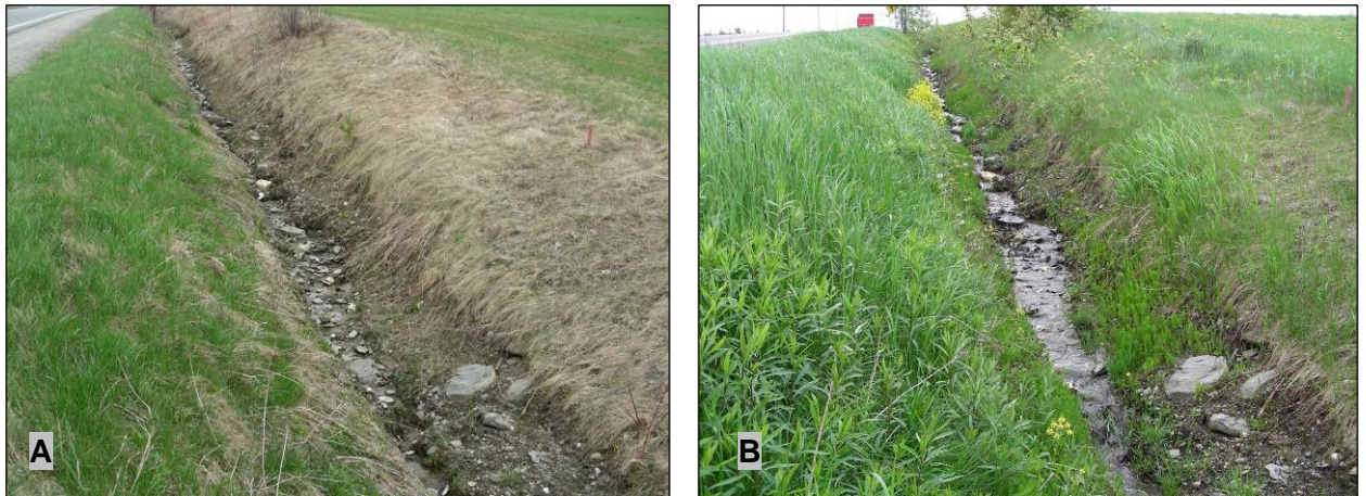
Figure 104 : Stabilisation et reprise de la végétation dans le fossé du site n° 9 au mètre 85 : A) la présence de blocs favorise la stabilisation du fossé et l'érosion se fait latéralement (1 er mai 2006); B) reprise rapide de la végétation sur les talus en 2006 (23 mai 2006)
