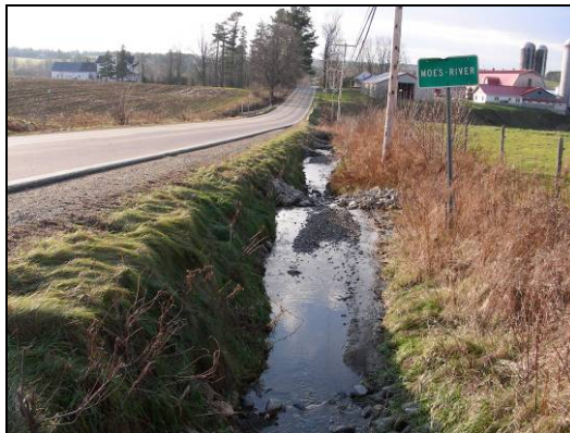
Figure 7 : Bassins des bermes du site n° 10 exigeant un nettoyage (21 novembre 2005)
