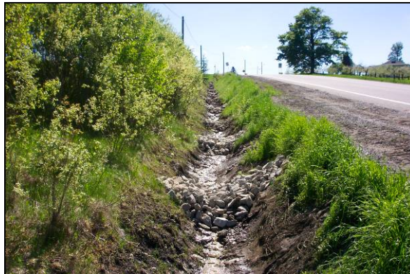
Figure 35 : Disposition normale des seuils en pierres vus de l'aval au site no 5 (1er juin 2005)
