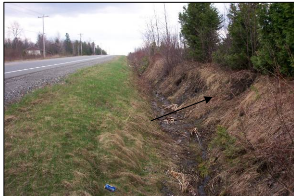
Figure 38 : Glissement résultant du sapement basal dans la partie aval du fossé du site no 6 avant le nettoyage (2 mai 2005)
