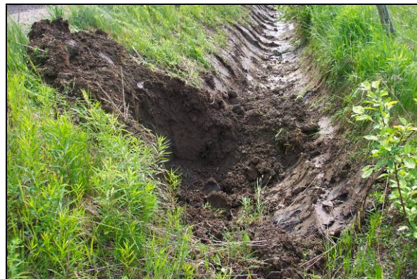
Figure 46 : Emplacement d'un bloc qui a été enlevé au mètre 87 du site n° 8 (6 juin 2005)
