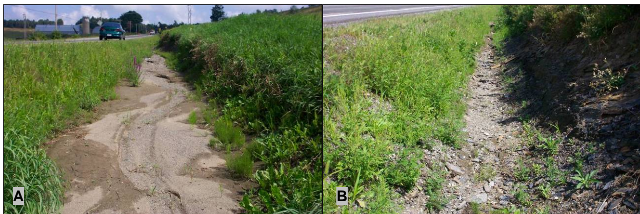
Figure 114 : Évolution du fossé du site n° 11 (15 août 2005); A) accumulation de matériaux au transect 1; B) reprise de la végétation sur les talus
