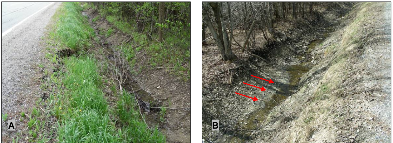
Figure 78 : Érosion par fluage dans le fossé du site n° 1 : A) cicatrice à la limite de l'accotement entre les mètres 122 et 127 (23 mai 2006); B) déviation de l'écoulement vers le talus du côté de la route (19 avril 2006)
