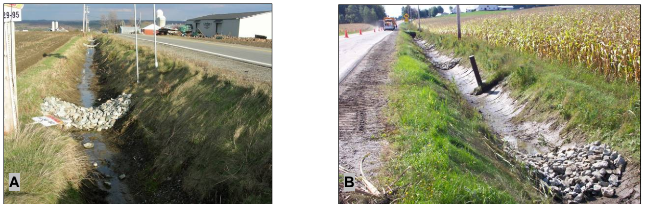
Figure 71 : Fossé du site n° 14 après le nettoyage montrant les effets d'une excavatrice surdimensionnée : A) talus du côté opposé à la route à moitié dénudé de végétation (21 novembre 2005); B) filage de Bell Canada découvert au cours du nettoyage dans la partie aval du fossé (19 septembre 2005)
