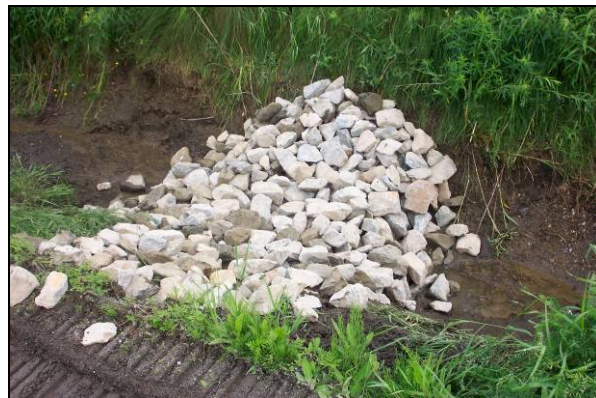
Figure 63 : Seuil installé au mètre 28 du site n° 12 pour stabiliser l'endroit à la suite d'un petit glissement (13 juin 2005)
