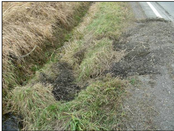
Figure 83 : Défoncement du talus du côté de la route du site no 3 (11 novembre 2005)
