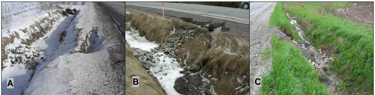
Figure 117 : Ravinement sur l'accotement de la route au seuil n° 2 du site n° 12 : A) première constatation de la présence du ravinement (10 mai 2006); B) ravinement plus important et présence d'un piquet indiquant qu'il y aura une intervention (22 mars 2006) : C) réparation de l'accotement et destruction du seuil (23 mai 2006)
