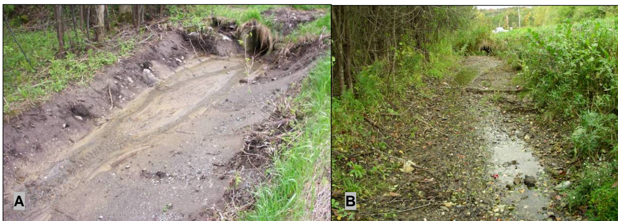
Figure 123 : Accumulation en amont du ponceau au mètre 40 du site n° 1 : A) faible accumulation quatre jours après le nettoyage (29 mai 2005); B) accumulation de matériaux sur plus de 30 m (26 sept. 2006)
