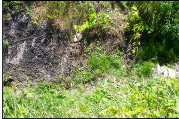
Figure 50 : Amoncellement d'asphalte dans le fond du fossé au mètre 187 du site n° 9 (20 juillet 2005)
