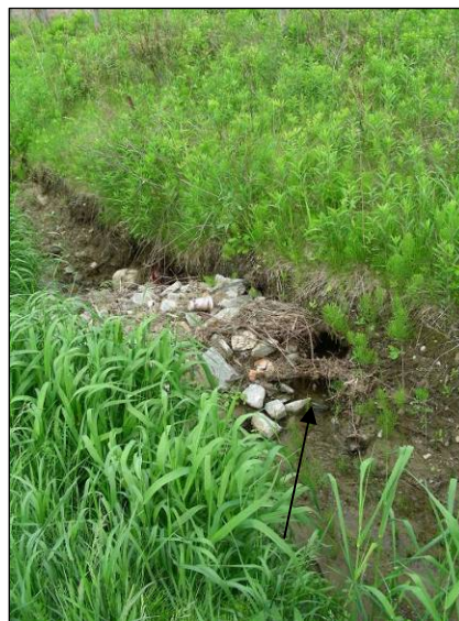
Figure 81 : Érosion sous le talus du côté opposé à la route dans le fossé du site n° 2 entre les mètres 12 et 15 (2 juin 2006)
