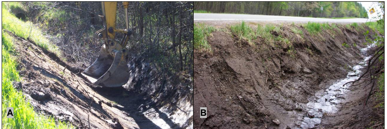
Figure 75 : Nettoyage du fossé du site n o 1 : A) bande de végétation laissée sur le talus du côté de la route au moment du nettoyage du fossé (25 mai 2005); B) érosion par fluage sur le talus du côté de la route (29 mai 2005)
