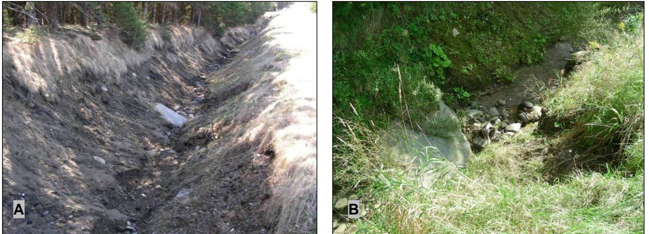
Figure 99 : Érosion sur le talus du côté de la route au mètre 129 du fossé du site n° 7 : A) début d'érosion au printemps 2006 (23 mai 2006); B) décrochement de la végétation (23 août 2006)
