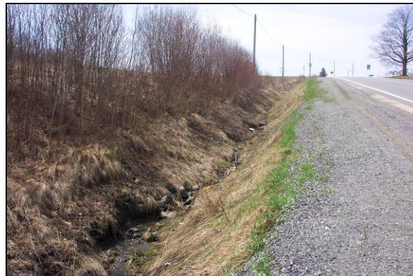
Figure 32 : Marques d'érosion aux mètres 15 à 20 du site no 5 avant le nettoyage (26 avril 2005)
