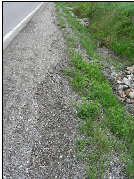
Figure : 86 Érosion par ravinement sur l'accotement de la route dans le fossé du site no 4 (23 mai 2006)
