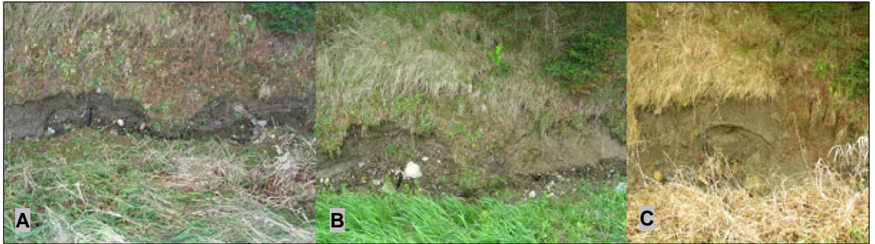
Figure 100 : Érosion importante entre les mètres 112 et 115 du fossé du site no 7 : A) les fils de Bell Canada sont dénudés au mètre 114 (17 novembre 2005) ; B) érosion plus importante entre les mètres 113 et 115 (23 mai 2006); C) décrochement d'une portion du talus entre les mètres 112 et 115 (28 novembre 2006)
