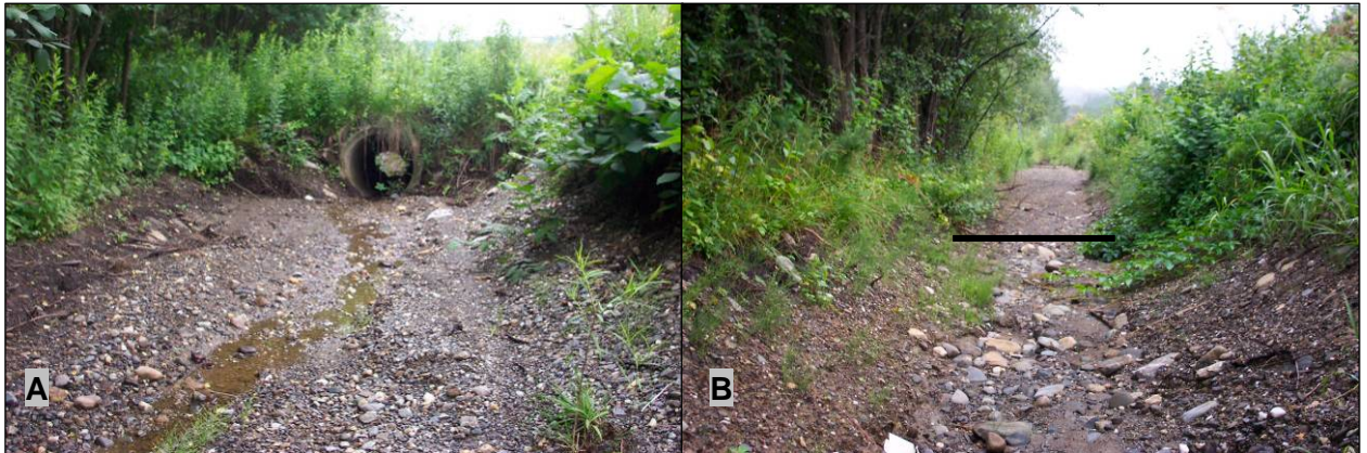
Figure 77 : Accumulation de sédiments dans le fossé du site n° 1 : A) en amont du ponceau (26 juillet 2005); B) accumulation causée par le bassin de sédimentation (15 août 2005)
