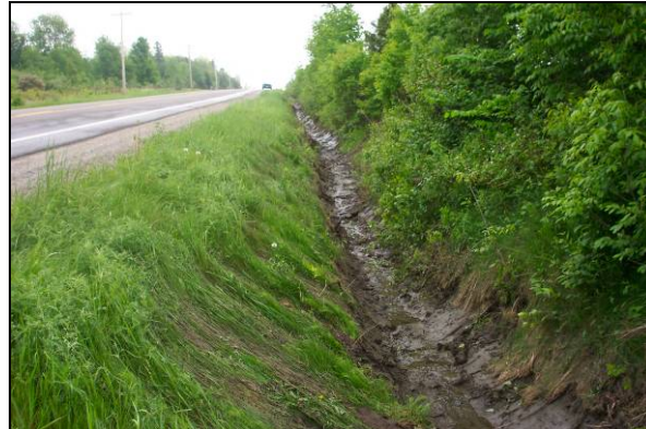
Figure 39 : Zone aval plus sensible à l'érosion que la zone amont au site n° 6 après le nettoyage (8 juin 2005)
