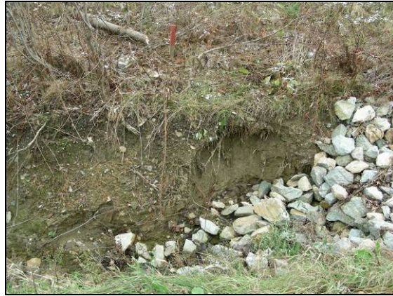
Figure 80 : Érosion importante du talus opposé à la route du fossé du site n° 2 au mètre 187 (11 novembre 2006)
