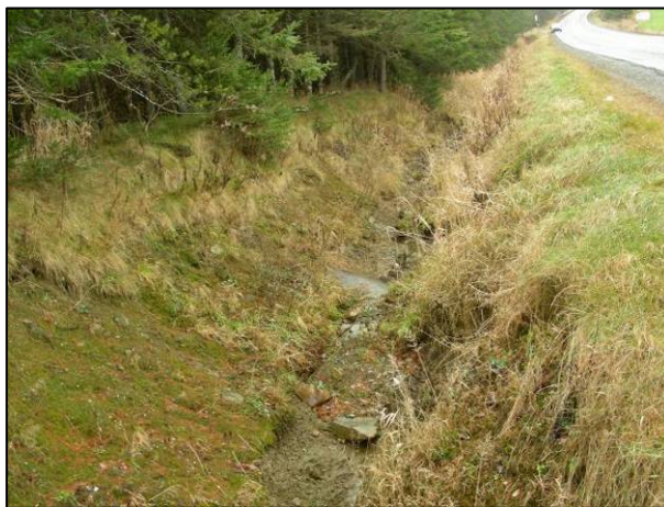
Figure 101 : Faible reprise de la végétation dans le fossé du site n° 7 (28 novembre 2006)
