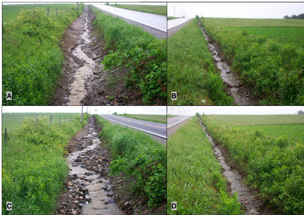
Figure 107 : Écoulement de l'eau et érosion dans le fossé des sites n os 9 et 10 : A) débit moyen dans le fossé du site n o 10 (14 juin 2005); B) débit moyen dans le fossé du site n o 9 (14 juin 2005); C) fort débit et érosion dans le fossé du site n o 10 (17 juin 2005); D) débit moyen et stabilité du fossé du site n o 9 (17 juin 2005)
