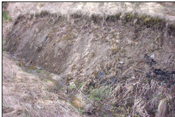
Figure 41 : Zone d'érosion pelliculaire entre les mètres 127 et 152 dans le fossé du site no 7 (2 mai 2005)
