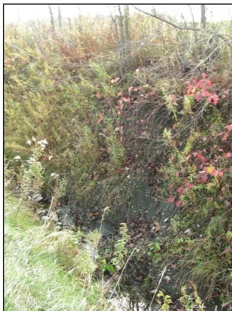
Figure 92 : Absence de végétation sur le talus du côté opposé à la route au mètre 64 du fossé du site no 6 (13 octobre 2006)
