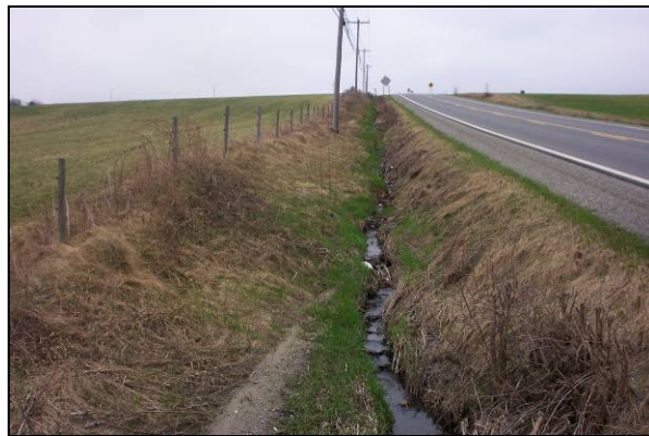
Figure 53 : Site n° 10 vu de l'aval avant le nettoyage et sédiments déposés à l'occasion de crues (2 mai 2005).
