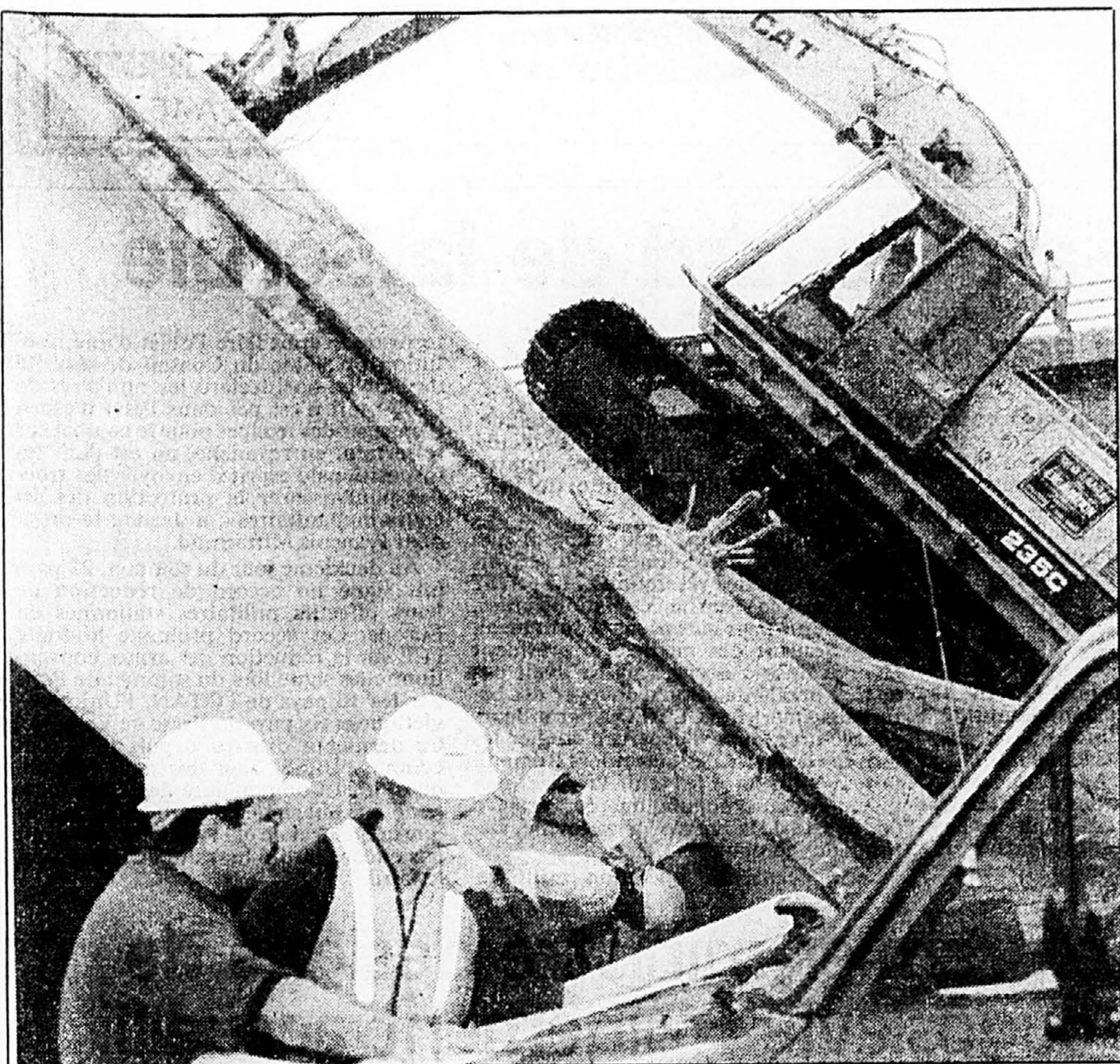
Elisa Kassab, du Laboratoire de l'Estrée, une firme conseil en résistance du béton, et Denis Bérubé, de Transports Québec, étudient les plans du pont qui s'est effondré sur l'autoroute 20, à la hauteur de Notre-Dame-du-Bon-Conseil.
