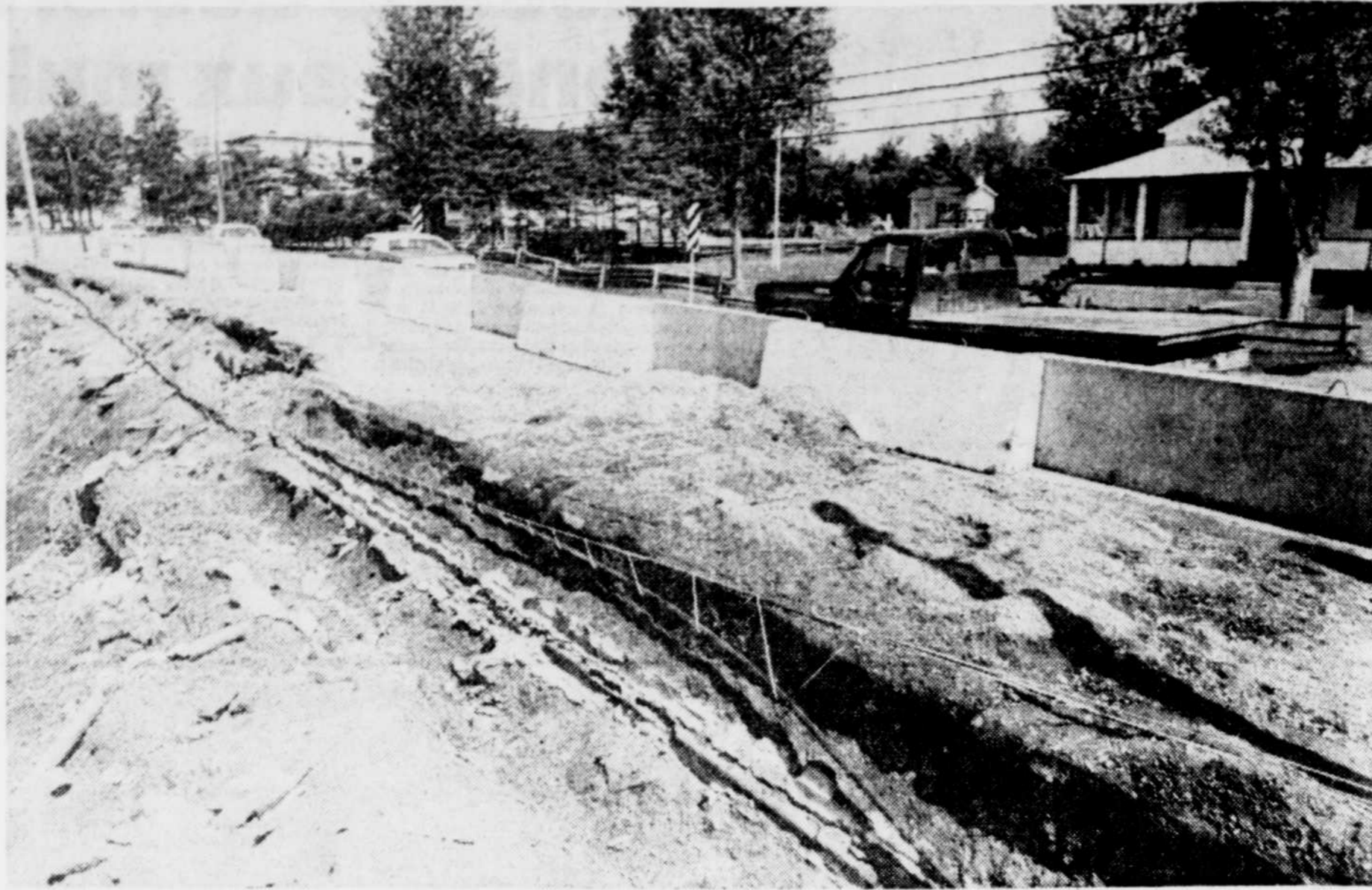
Ca circule difficilement sur le boulevard Saint-Jacques et on pense à le fermer en partie au cours du prochain hiver. Le Soleil, Jean-Marie Villeneuve
