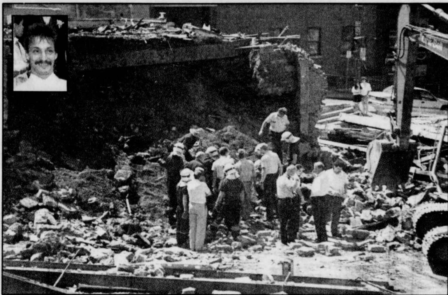
Les pompiers et policiers ont mis plus d'une heure à dégager le corps de l'ouvrier. Le mur qui s'est désagrégé en s'effondrant avait presque deux pieds d'épaisseur. Au premier plan, on aperçoit ce qui reste du casque que portait Dany Côté (en mortaise).
