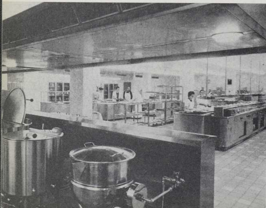
La cuisine, située au sous-sol, est spacieuse et amplement ventilée. Les tables, les fours et le matériel d'équipement sont en acier inoxydable.
