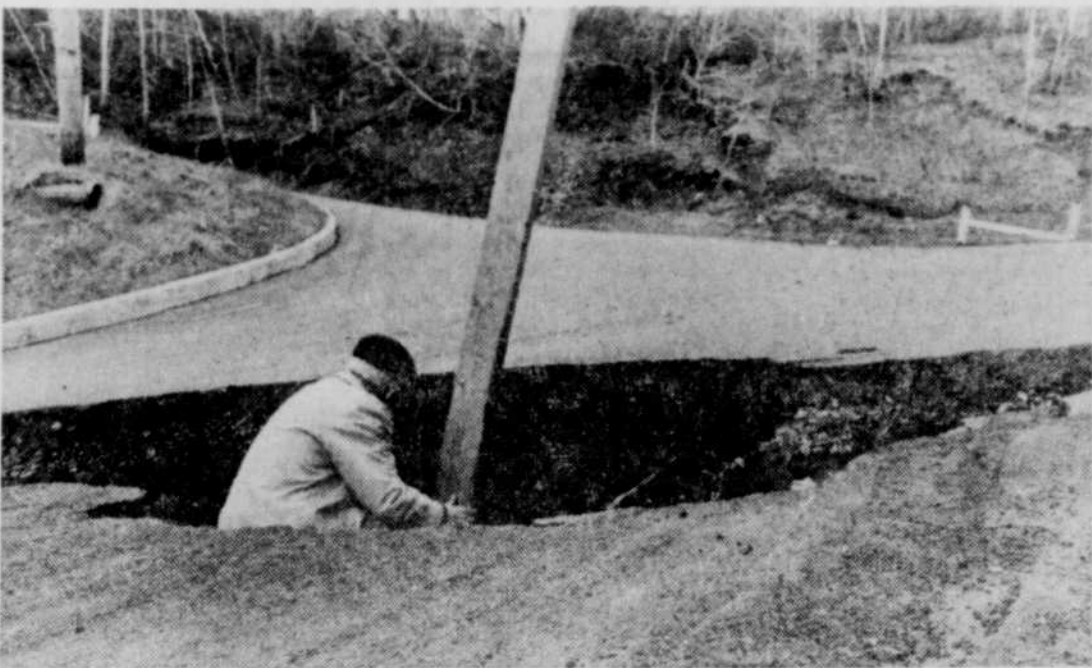
C'EST CREUX, HEIN? Eh! Ouil! En novembre l'affaissement dans la côte de Boischatel était d'une profondeur de 6 à 7 pouces, mais le 15 mars 1973, le trou béant avait une profondeur d'au moins deux pieds, avec des cravasses multiples qui se perdaient sur le pavé de cette côte achalandée. La circulation a été fermée par la Voirie provinciale, mais des hardis automobilistes ne se gênaient pas pour renverser les tréteaux et faire fi des avertissements.
