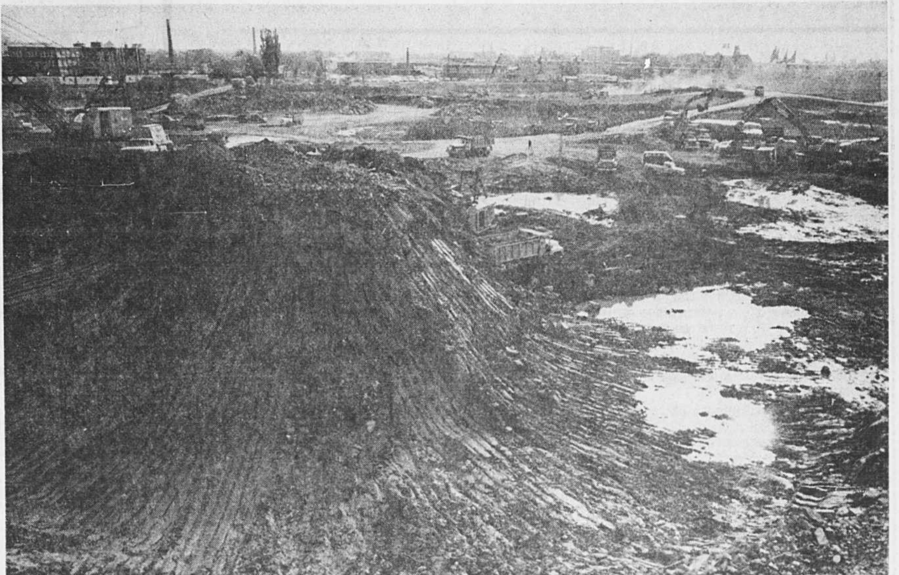
Cette photo nous donne une bonne idée de l'état très avancé de l'excavation, qui doit être terminée, conformément au contrat, le 3 novembre. A moins que la température ne s'en mêle le consortium Simard-Beaudry-Dumez Canada devrait avoir terminé à temps.
