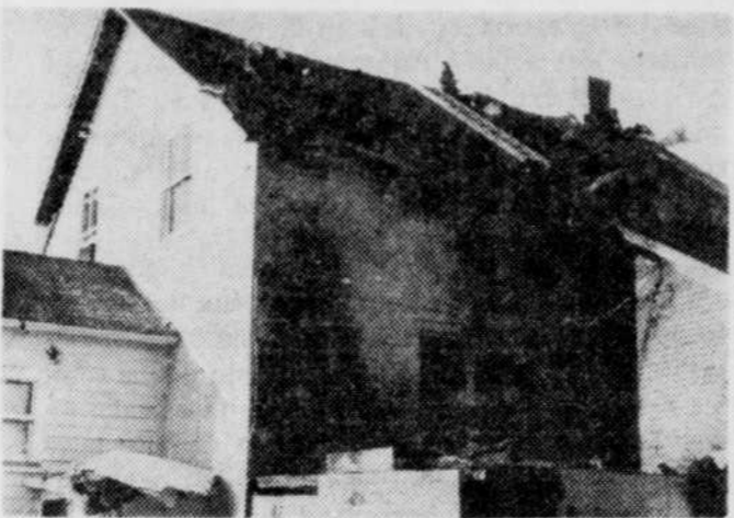
L'édifice qui a été la proie des flammes.
