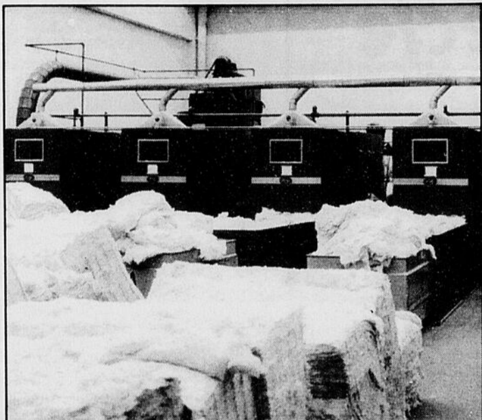
Spécialiste des grands projets, la plomberie A.R. Wilson a entre autres, exécuté de nombreux travaux dans les usines de textiles de Sherbrooke et de la région. Ici des mélangeurs de coton et des aérateurs.
