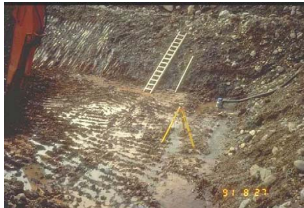
4. Fond d'excavation détrempe à assécher
