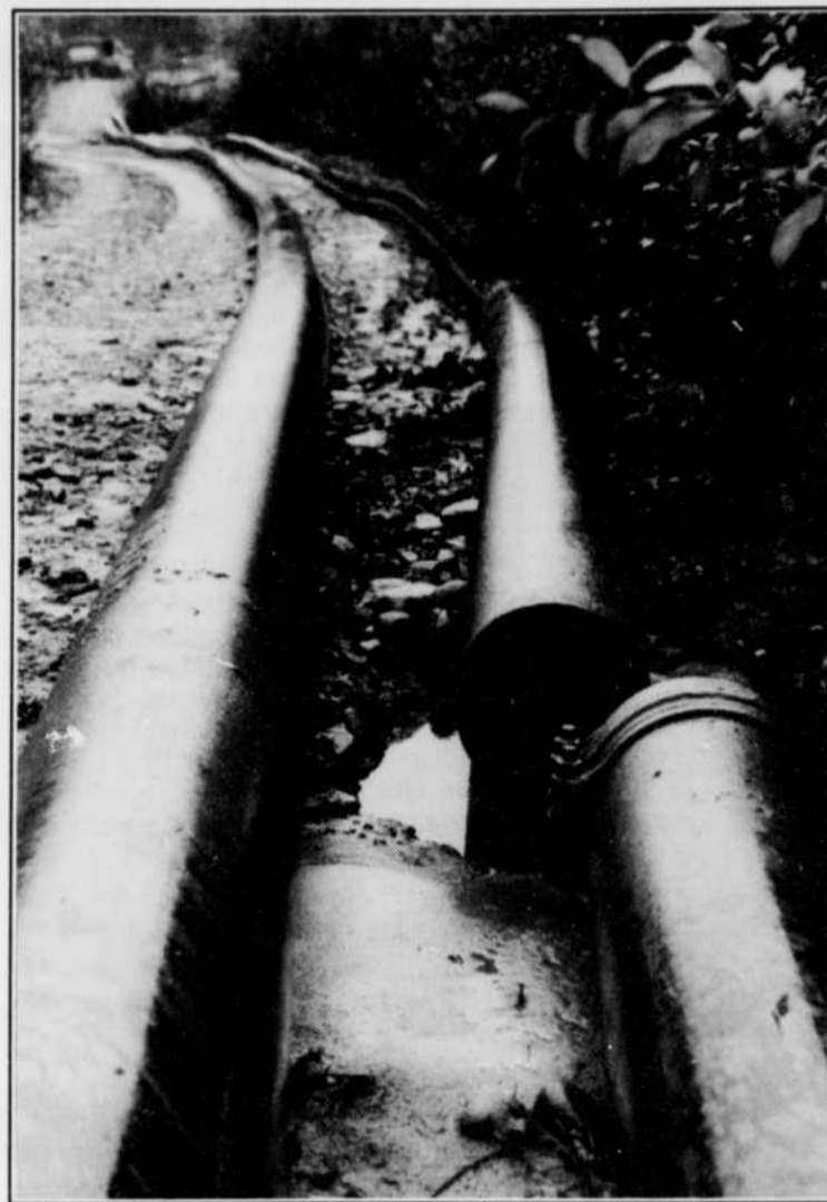
Cette photo a été prise en octobre 1989. C'est cette canalisation qui s'est brisée, entraînant un déversement de boue rouge à proximité du bassin de sédimentation situé à proximité de Laterrière.
