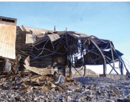
Bâtiment industriel après un incendie
