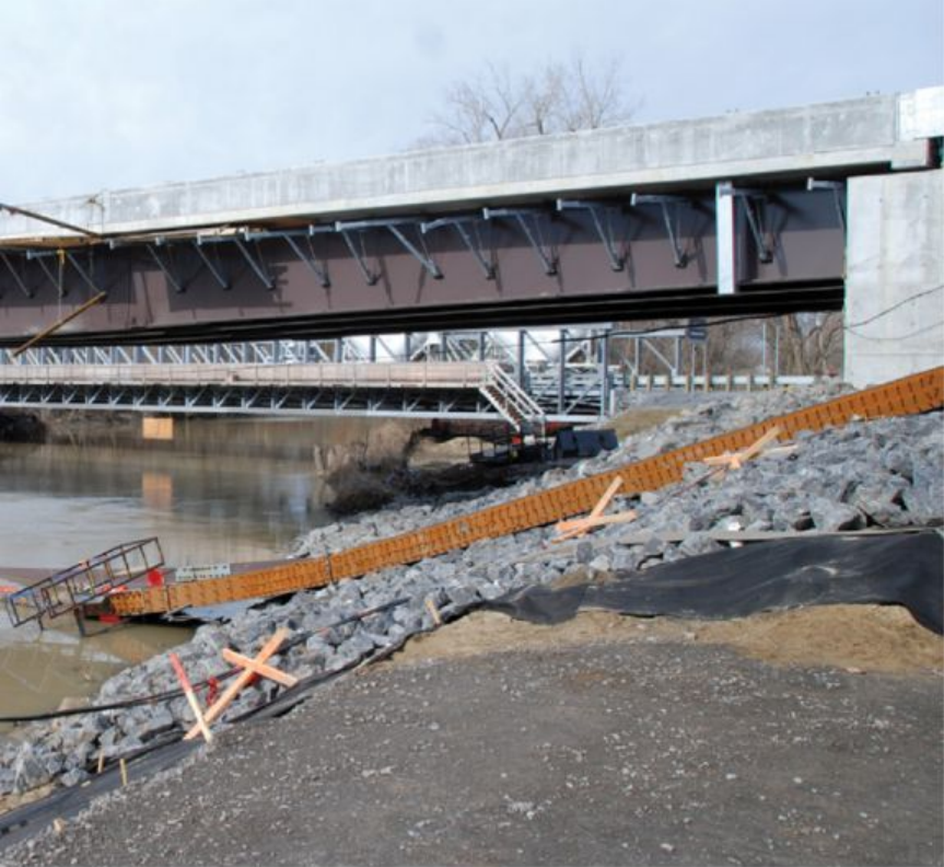
Effondrement d'une poutre durant la construction d'un pont
