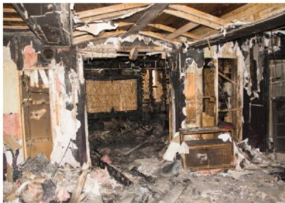
Résidence à la suite d'un incendie
