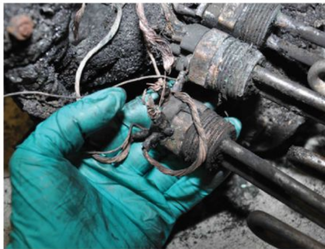
Étude de composante électrique dans le cadre d'investigation incendie
