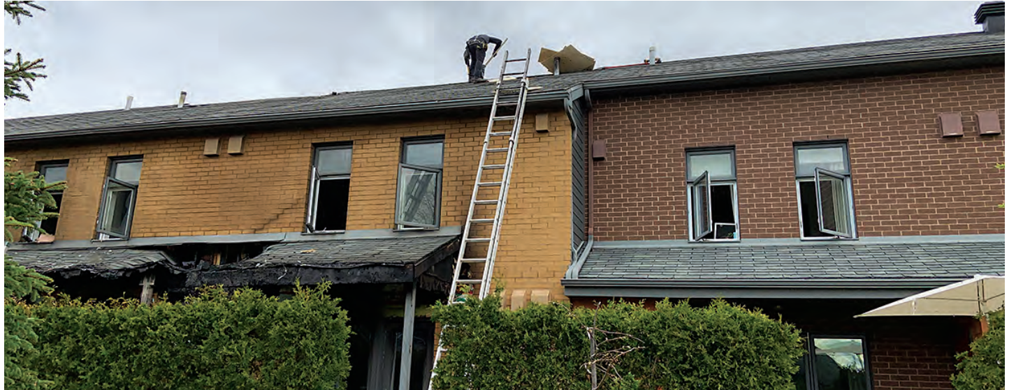
Six familles ont été touchées par l'incendie qui a endommagé un bâtiment de la Coopérative de solidarité en habitation. (Photo : Frank Jr Rodi)
