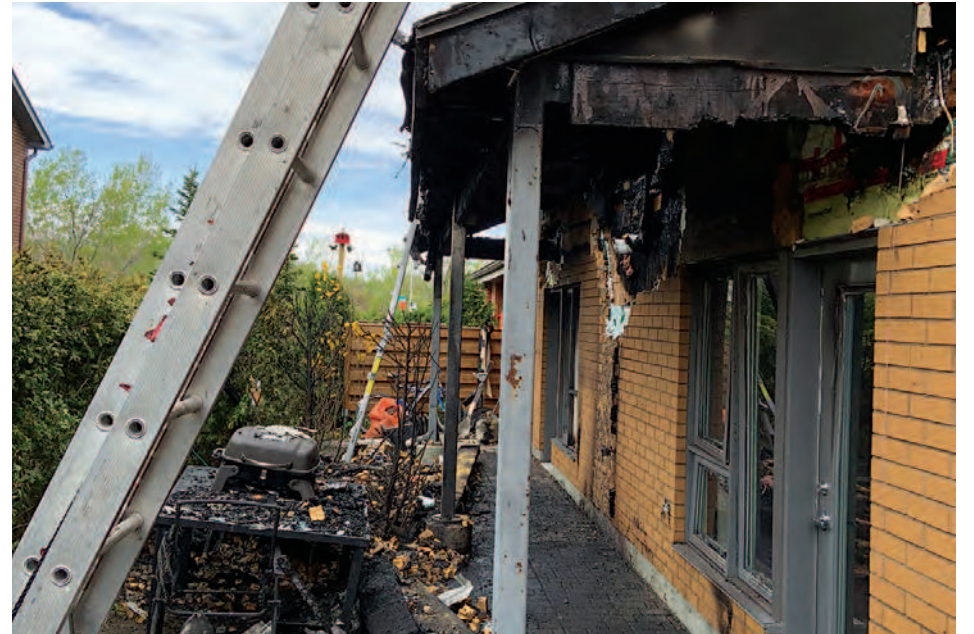
Le feu s'est déclaré à l'arrière du bâtiment. (Photo : Frank Jr Rodi)
