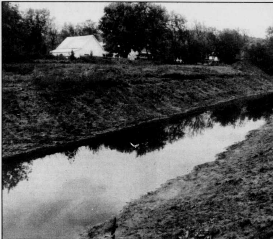
La municipalité a asséché le méandre naturel de la rivière et creusé une tranchée en ligne droite de 160 mètres de longueur par 20 mètres de largeur qui en constitue le nouveau cours. Le bassin d'eau doit servir aux pompiers. Des citoyens s'insurgent contre le procédé, qui violerait les règles environnementales.
