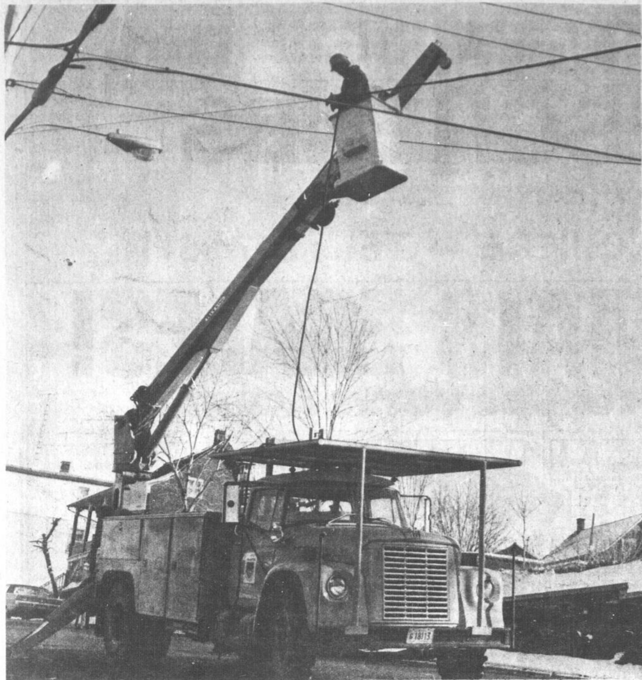
TRES AFFAIRES: Les équipes de l'Hydro-Québec ont été très affairées, toute la journée d'hier pour réparer les bris de câbles et rétablir le service à quelque 12,000 abonnés à travers toute la région.
