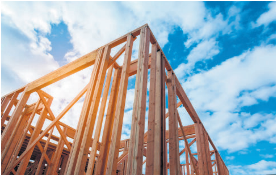
Avec ce projet de développement, 66 maisons unifamiliales pourraient être construites au bout du chemin Sterrett Mine dans la municipalité du Canton de Cleveland.
