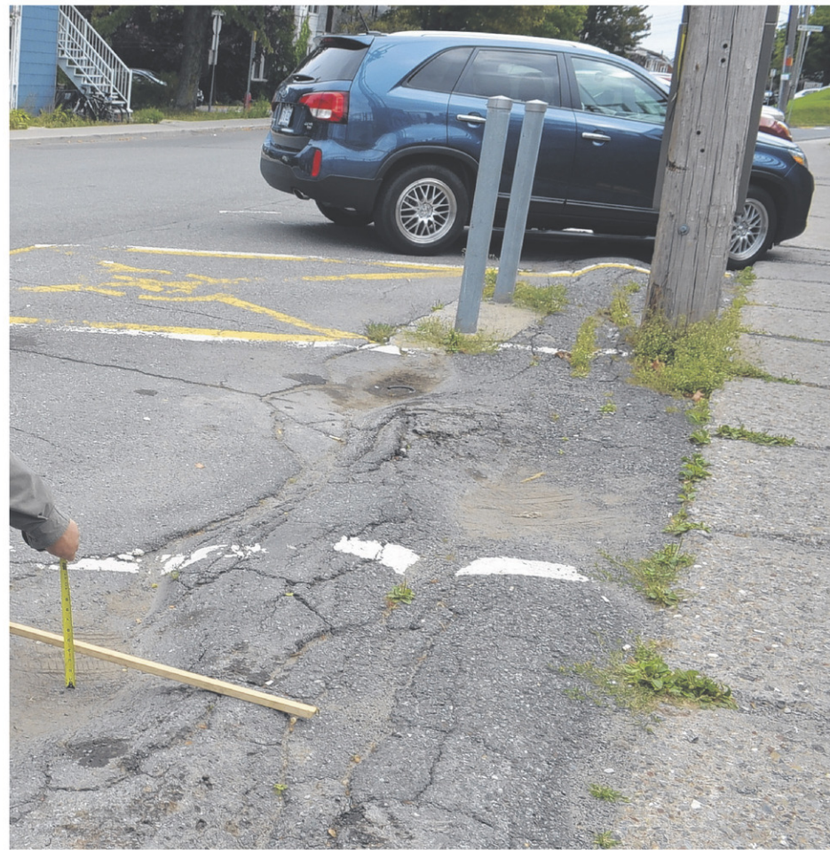
La chaussée est dans un piètre état dans ce secteur. (Photo TC Media – Hélène Ruel)
