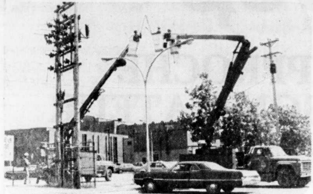
Cette photo montre 3 monteurs de la compagnie Arno construction effectuant des modifications à une ligne de distribution. Ces travaux font partie d'un programme d'Hydro-Québec, entrepris depuis le mois de mai, afin de normaliser les différentes tensions du réseau de distribution dans certains quartiers de Sorel, Tracy et Saint-Joseph-de-Sorel.
