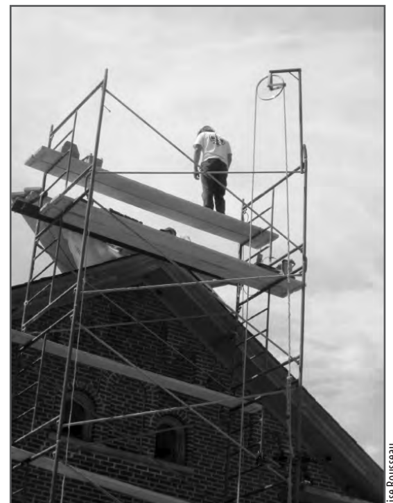
Les travaux de réfection de l'ancienne gare de Saint-Armand sont en cours au cœur du village.
