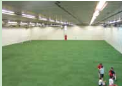
Bâtiment industriel transformé en terrain de soccer à sept avec des plaques de gazon synthétique sans remplissage. La hauteur du plafond est insuffisante et les appareils d'éclairage ne sont pas protégés.
