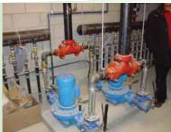
Dans un des complexes de soccer intérieur visités, l'exploitante ou l'exploitant a mis en place un système de chauffage utilisant la géothermie.
