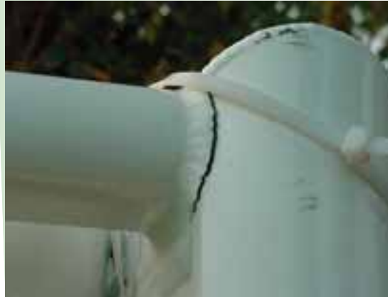
Cette structure de but est affaiblie.
