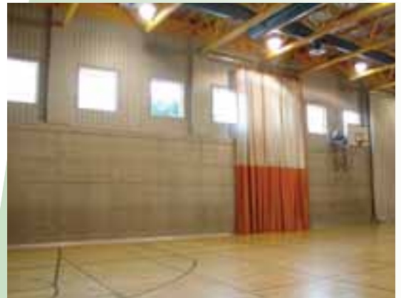
Un remisage adéquat du rideau qui longe le mur.
