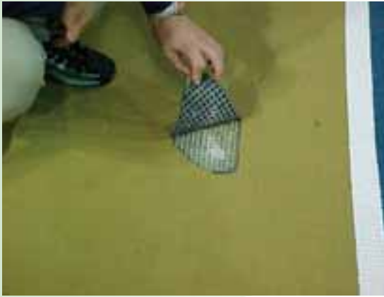
La surface est dangereuse pour les joueuses et les joueurs.
