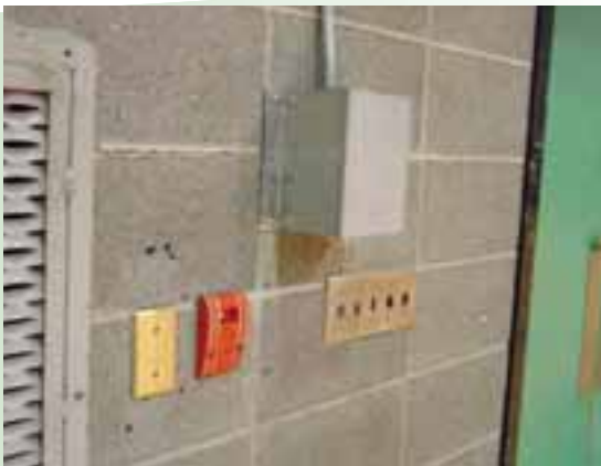
La boîte de raccordement électrique se trouve à la hauteur du visage.
