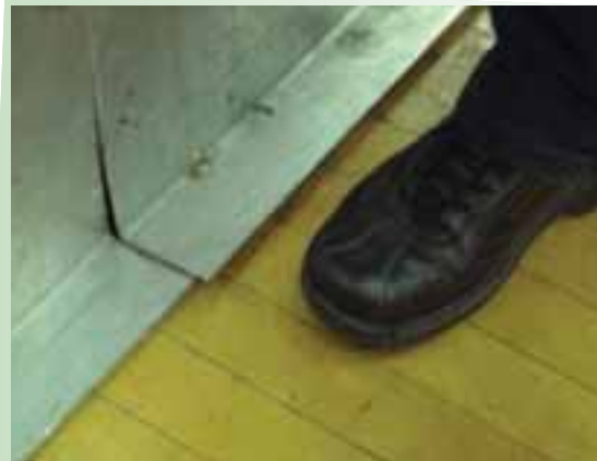
L'installation inadéquate des moulures peut être la source de blessures dans ce gymnase.
