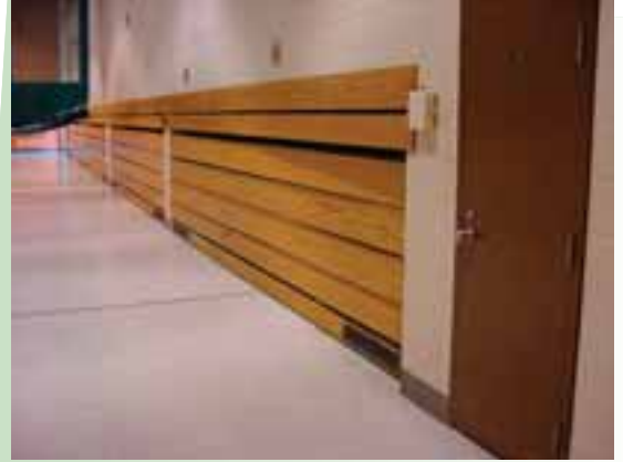
Les gradins escamotables libèrent le gymnase de contraintes. Toutefois, la poignée de la porte et le couvercle du thermostat peuvent être accrochants.
