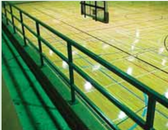
Les barres horizontales rendent cette balustrade dangereuse. Un enfant peut facilement passer entre deux barres ou grimper sur la balustrade.
