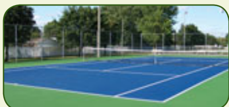
Travaux de pose de revêtement des terrains de tennis au parc Boardman
