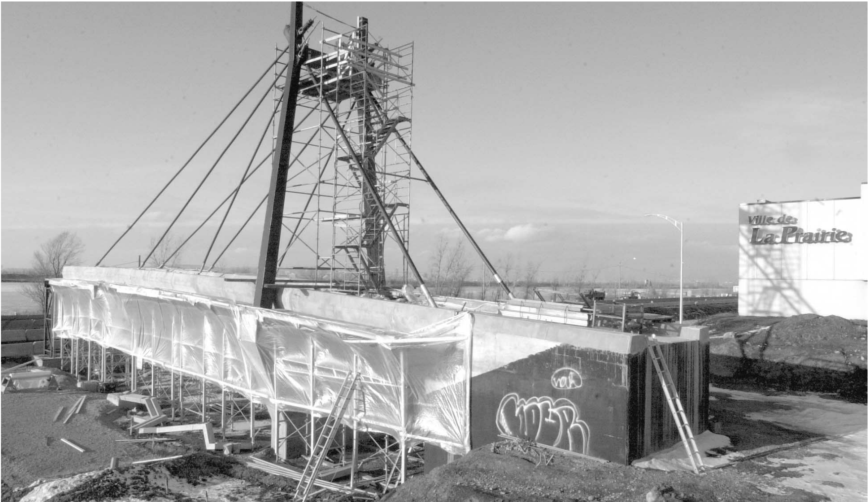
Cette passerelle en construction au-dessus de l'autoroute 15, à La Prairie, aurait des vices de construction tels qu'elle a bien failli s'effondrer, selon le ministère des Transports.
