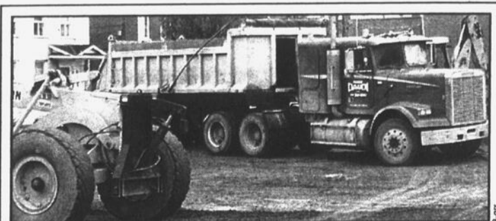
Pavage Doudi ltée, une entreprise johannaise, poursuit ses travaux au Centre des Aînés de Saint-Jean-sur-Richelieu. (Publi-reportage) 071108-1023-001
