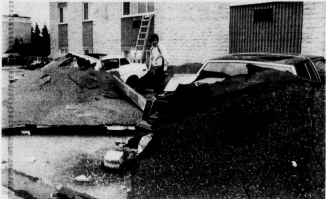
Le toit d'un édifice à logements a été arraché par le vents samedi à Winnipeg lors de la tempête.
