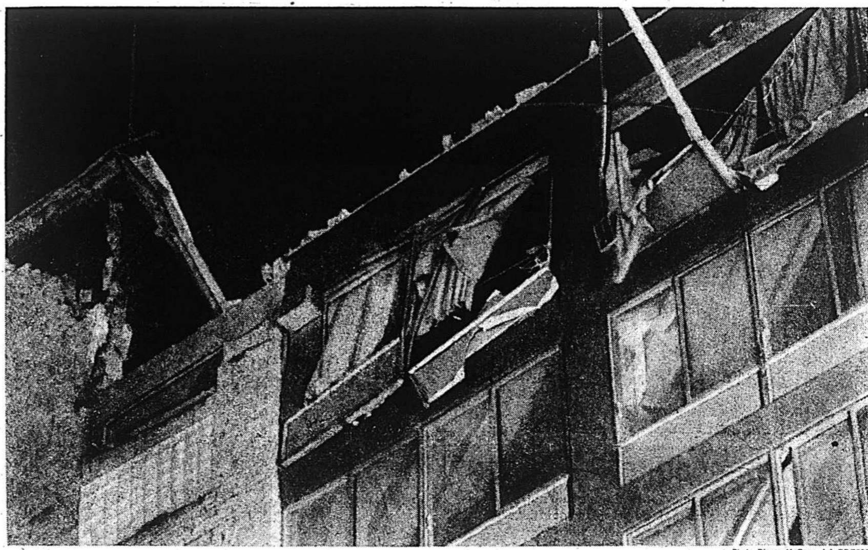
Les locaux de la délégation commerciale cubaine, située au 12e étage d'un immeuble, au 3737 est, boulevard Crémazie, ont été fortement endommagés, tôt ce matin, par l'explosion d'une ou plusieurs bombes.
