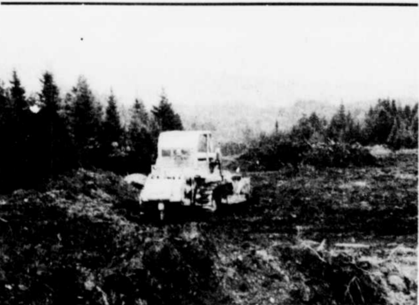
Des travaux ont été entrepris sur la route 263 entre St-Jacques le Majeur et St-Fortunat.
