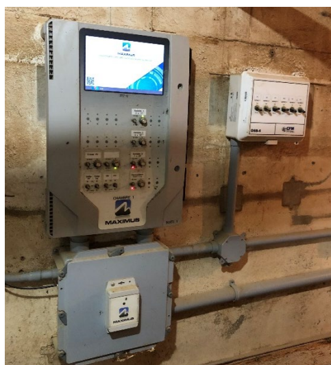
Figure 8 Contrôleur Maximus permettant de contrôler et de monitorer l'ambiance
