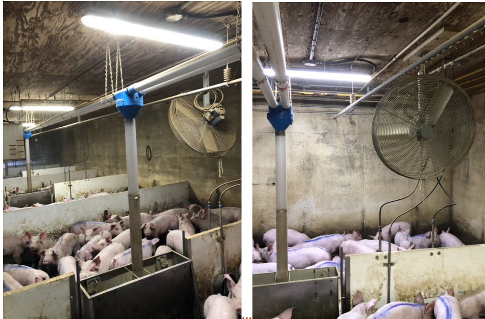
Figure 15 ventilateurs de recirculation dirigeant l'air vers l'extrémité opposée de la salle
