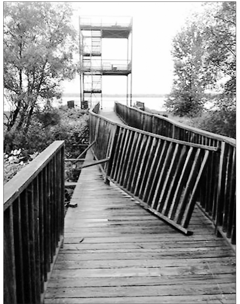
Deux fois au cours des dix derniers jours, des malfaiteurs ont brisé les rampes des passerelles de l'Anse-du-Port.
