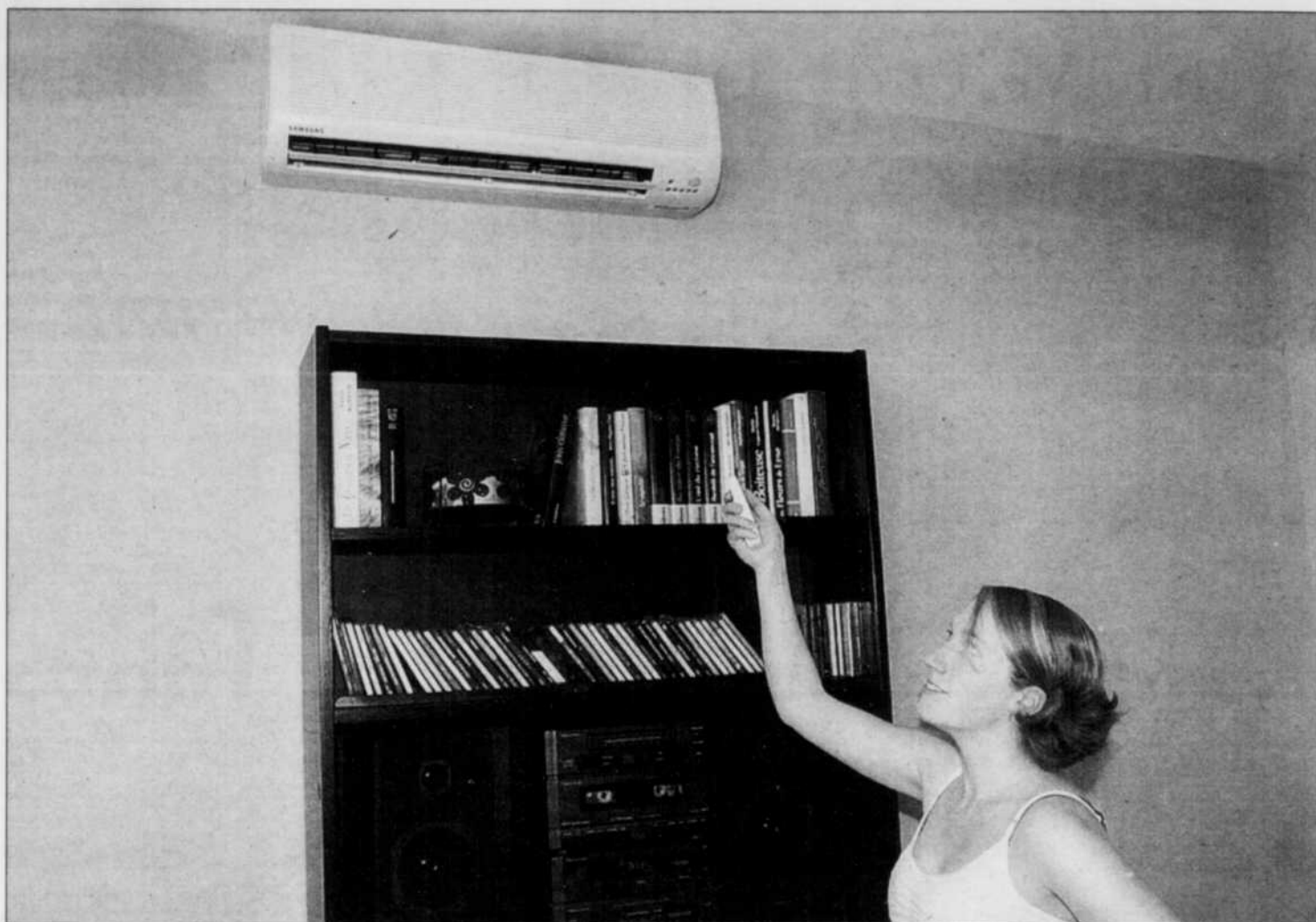
Un appareil de climatisation «bibloc» dont on fait généralement l'éloge quant à son efficacité, sa résistance et le confort qu'il procure. Ici, avec télécommande.
