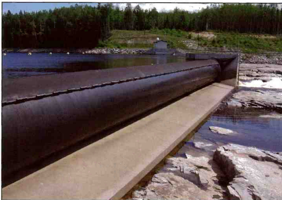
Centrale hydroélectrique Minashtuk, Dolbeau-Mistassini, (Propriété de Hydro-Ilnu et Hydro-Québec). La photo présente deux des trois vannes installées, soit : 3,58m x 50m et 3,58m x 60m. Une troisième vanne de 2,5m x 25m est installée dans le bras ouest de la rivière.
