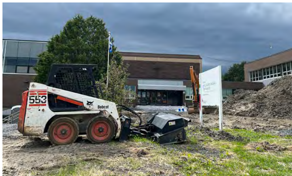
Des travaux étaient en cours, cet automne, sur le terrain de l'école Jacques-Rocheleau. (Photo : Frank Jr Rodi)
