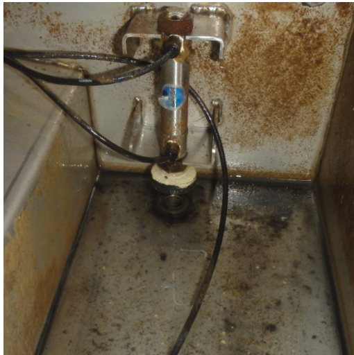
Figure 11 Bouchon et cylindre pneumatique à la base du réservoir
