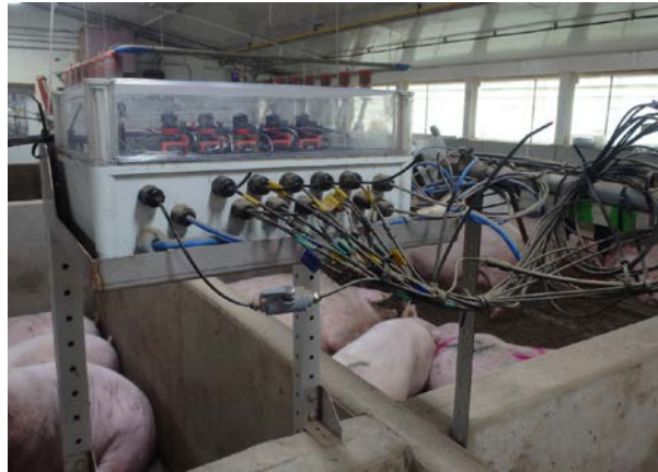
Figure 13 Boîtier de contrôle des systèmes de capteur à bulles
