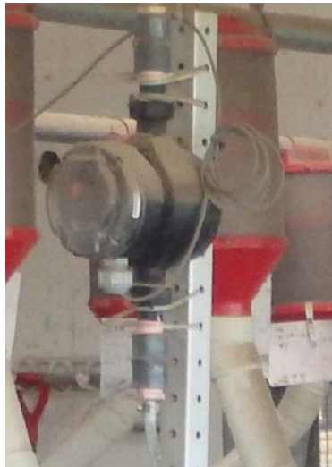
Figure 10 Photo d'un compteur d'eau installé pour mesurer le volume utilisé à une auge
