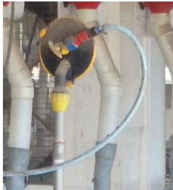
Figure 7 Membrane à vide utilisée pour maintenir le niveau d'eau constant dans les auges surélevées
