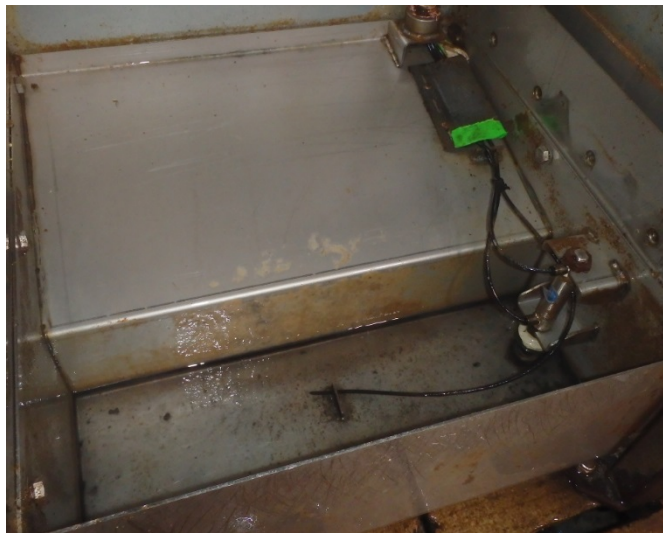
Figure 12 Tube d'air du système de capteur à bulles fixé sous le niveau d'eau minimal au fond du réservoir
