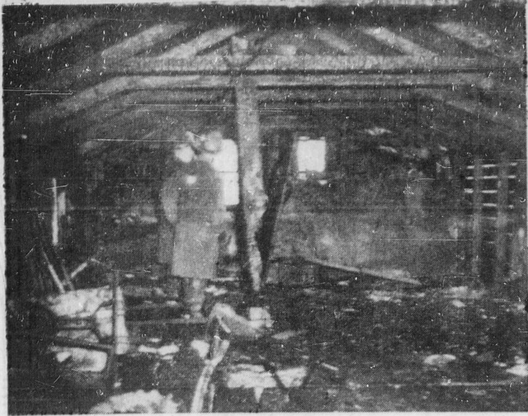
QUATRE PERSONNES SANS LOGIS—Deux pompiers examinent ici les dommages causés par le feu à la maison de M. et Mme Oscar Damphouse, 970, rue Taylor, hier. Les flammes ont surtout ravagé l'étage et la toiture. (Photo Champlain Marcel)
