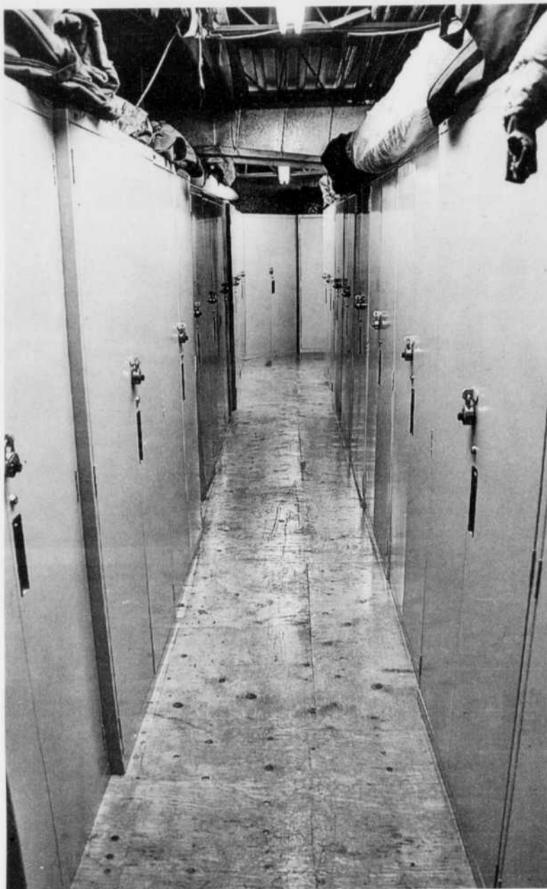
L'espace réservé pour les casiers des pompiers est rempli à pleine capacité. Il est d'ailleurs impossible d'ajouter un seul casier.
