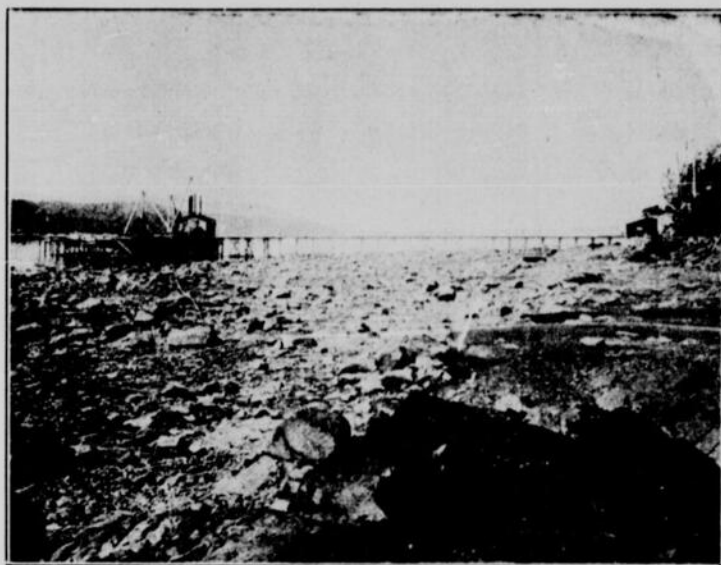
Vue de l'appontement et du quai temporaires, avec les pompes, grues, etc.
