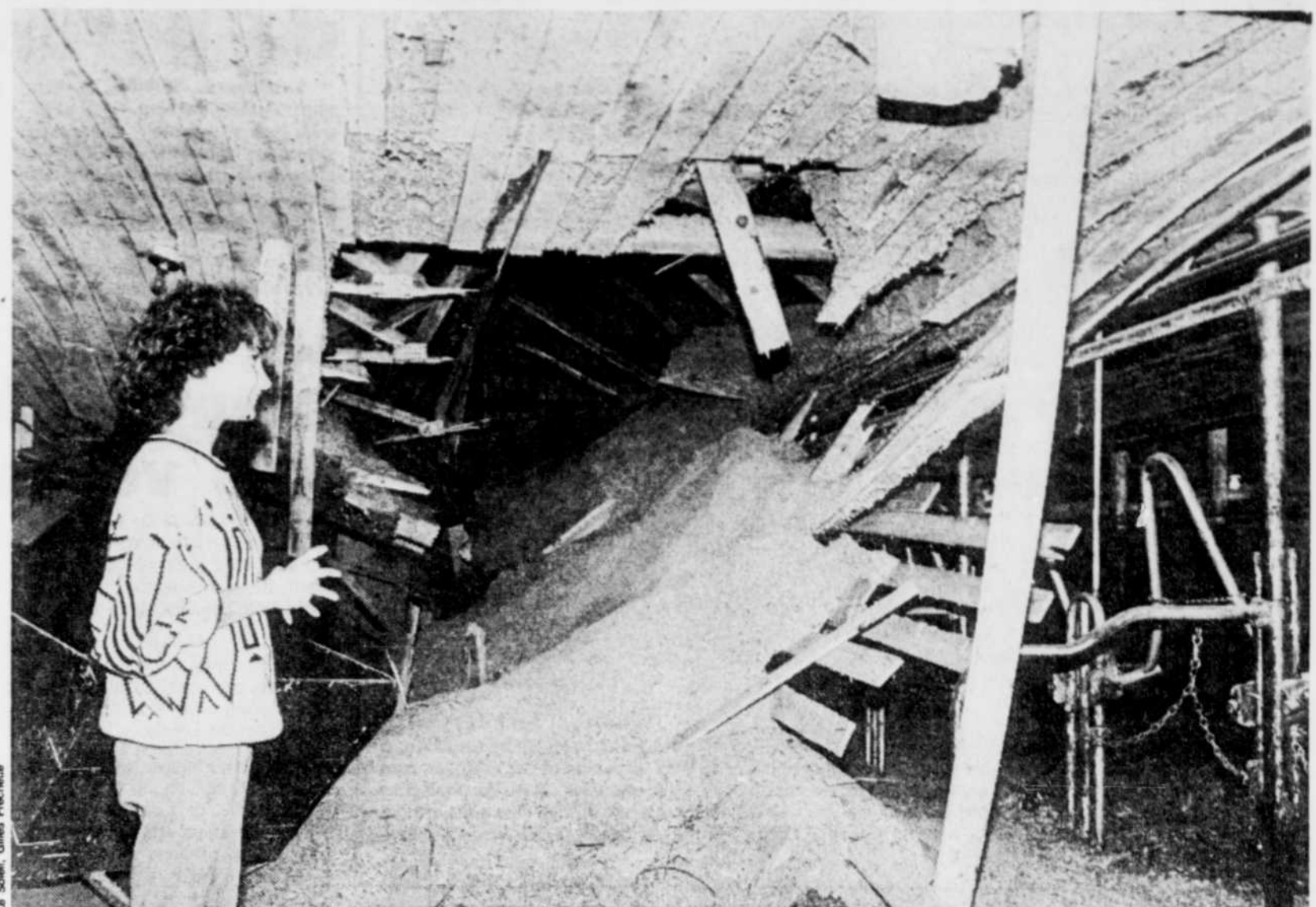
Une partie du plafond de l'étable de M. André Roussin s'est écroulée sous la force de la tornade et Nicole, l'une de ses filles, jette ici un coup d'oeil sur les dégâts.
