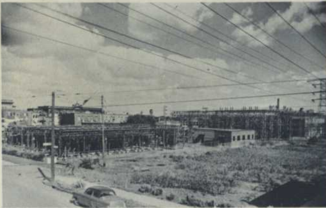
Jeanne d'Arc - 1 Stn. 90,000 KVA — 120/60/4KV 2 & 3 Stn. 127,000 KVA — 120/60/12KV
