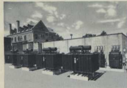
Roy Stn. 15,000 KVA — 12/4KV
