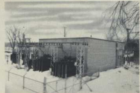
Cartierville Stn. 12,000 KVA — 12/4KV
