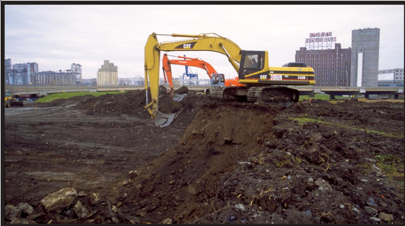
Travaux de déblaiement des bassins à farine (bassin Peel) en 2000. Crédit photo : Parcs Canada.
