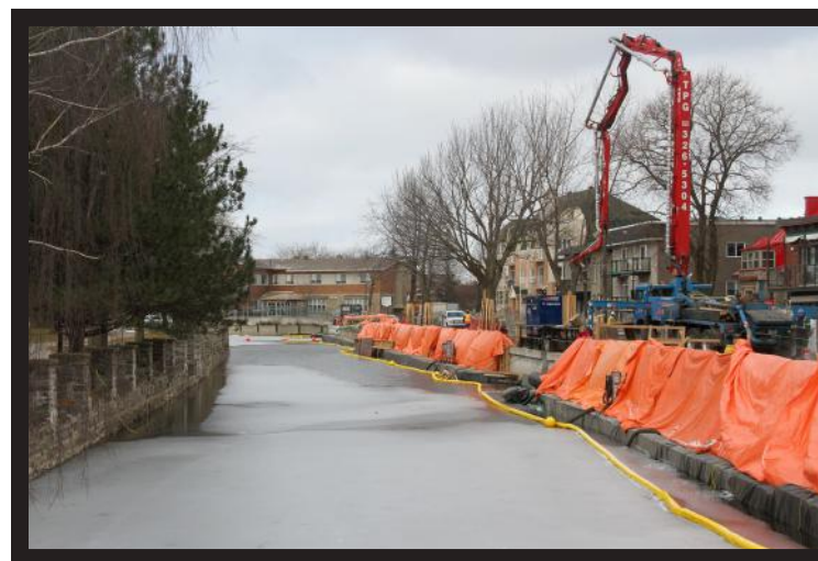
Réfection des murs dans le secteur Vieux-Canal en 2018. Crédit photo : Parcs Canada.
