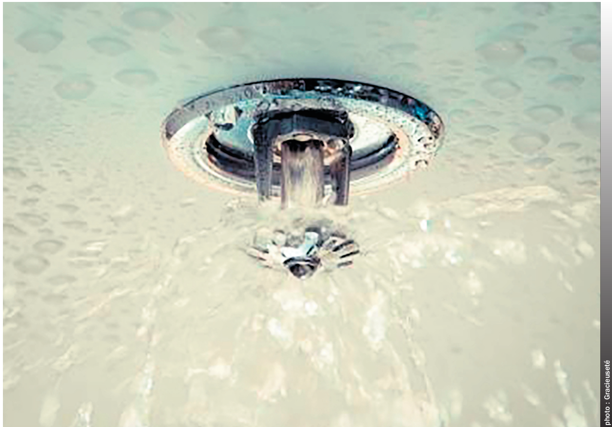
Les gicleurs sont devenus une obligation dans les résidences pour aînés depuis la tragédie de l'Isle-Verte.
