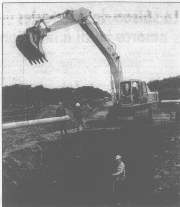
Yvon Martineau, le maire Normand Morin et Léandre Baillargeon donnent ici une bonne idée du chantier mis en place pour la création d'un parc industriel à Lambton.
