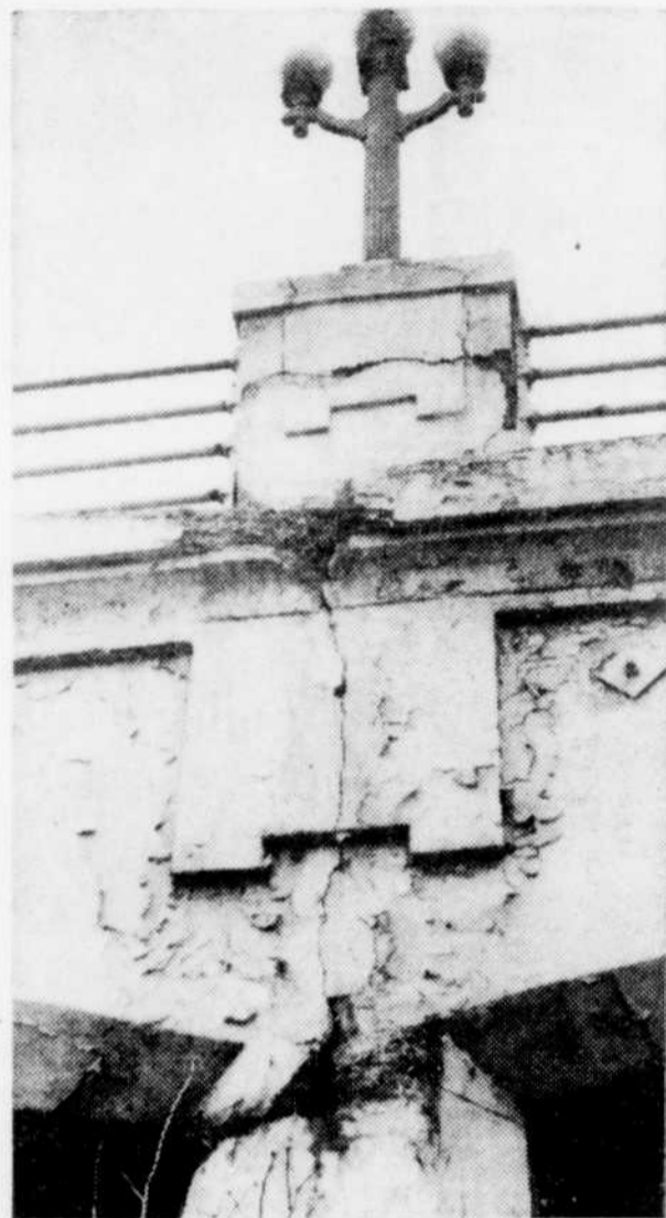
L'état lamentable de la terrasse Turcotte constitue une situation déplorable si l'on considère que cette promenade est située en plein dans le vieux Trois-Rivières. (Photo Roland Lemire)
