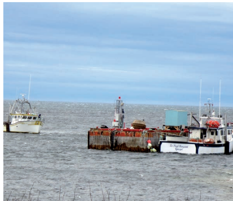
Transports Canada a restreint l'accès au quai de Baie-Johan-Beetz en raison de son état, en mai. (Photo : Courtoisie)
