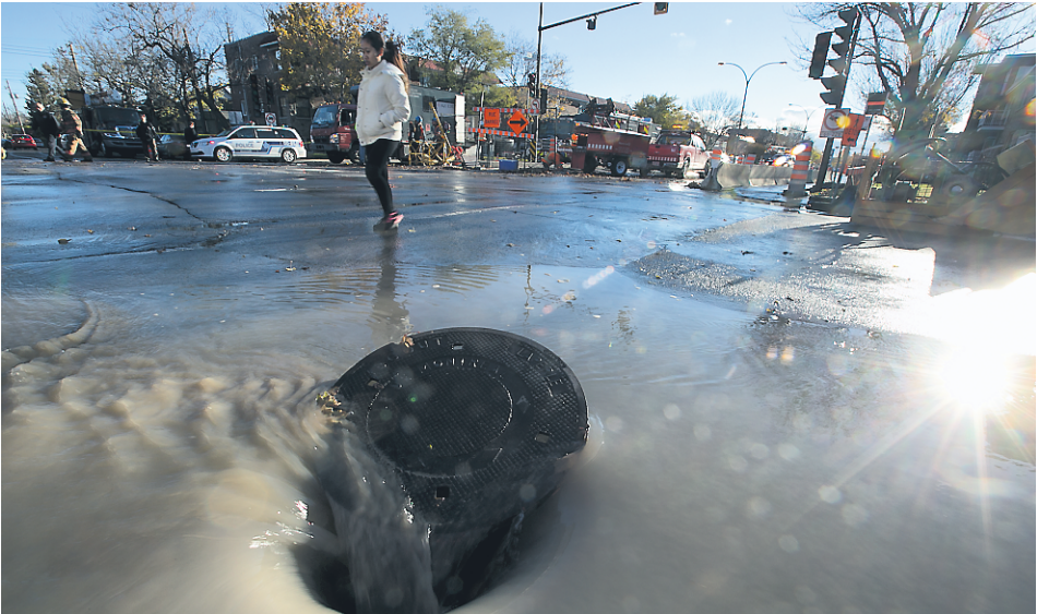
Une conduite avait cédé le 30 octobre dernier, entraînant une inondation dans l'arrondissement de Villeray-Saint-Michel-Parc-Extension et la fermeture d'un tronçon du boulevard Pie-IX.
