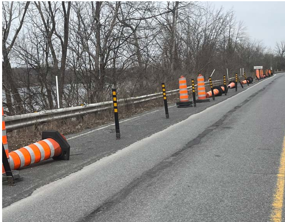
Un risque d'affaissement a été identifié en 2017 en marge de la route 133. (Photos : Jean-Christophe Noël)
