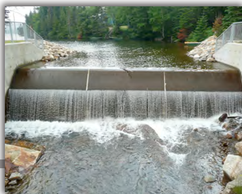
▼ Déversoir libre en béton
