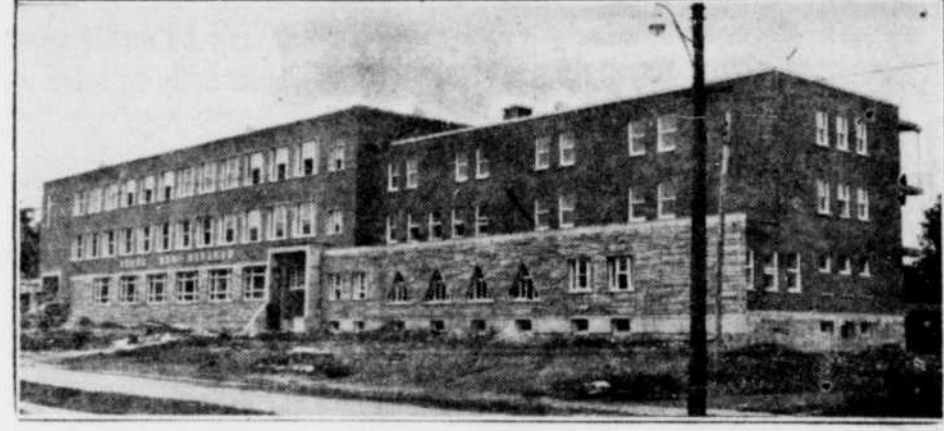
L'école Ste-Thérèse de l'Enfant-Jésus de Cowansville, actuellement en construction, à l'arrière de la nouvelle église Ste-Thérèse. Ce contrat a été accordé à Desourdy Construction de Cowansville.
