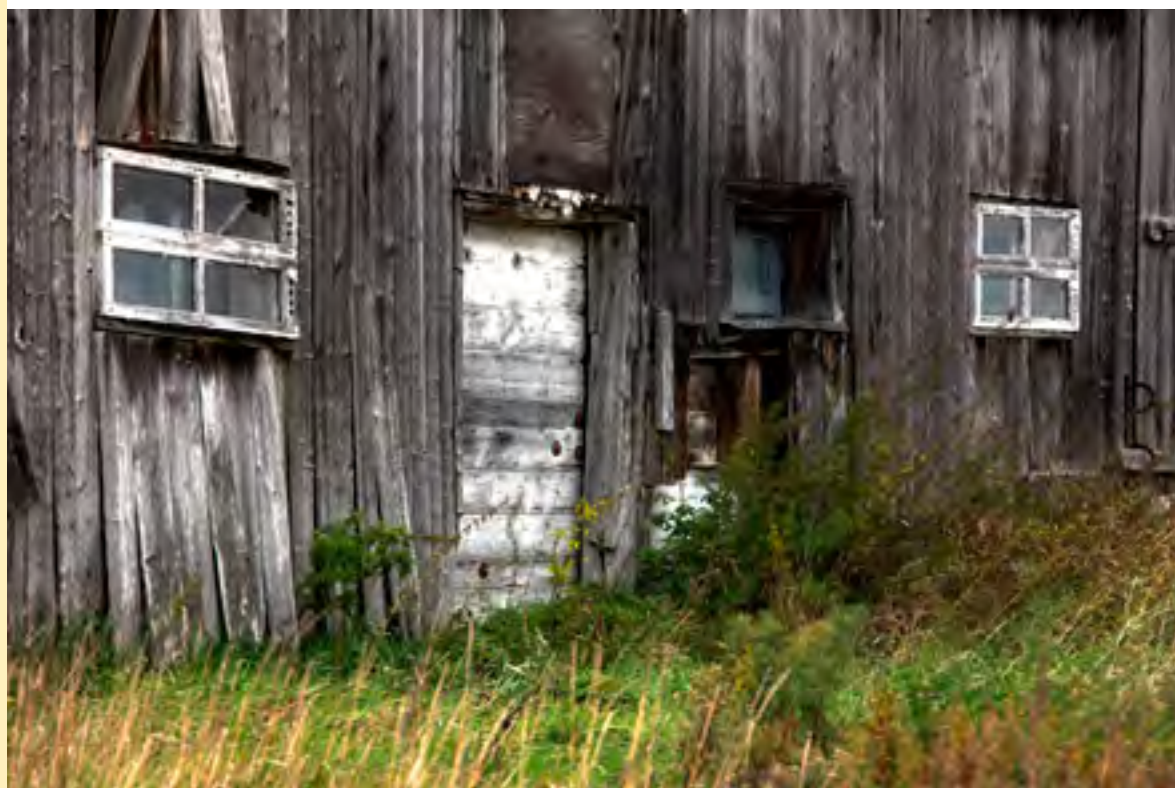
// Accès envahi par les herbes sauvages
