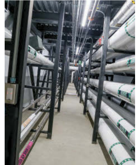
Une série de tuyaux relie l'usine de Bel à celle de la Maison Riviera, pour permettre entre autres le transport du lait.
