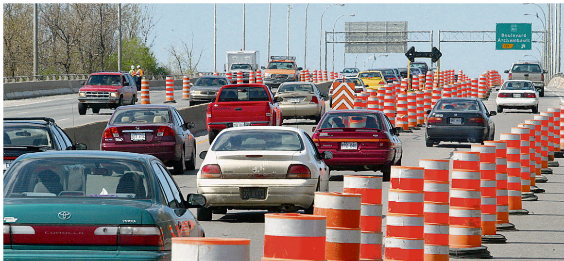
Le joint central du pont des Draveurs a été jugé non conforme par le MTQ, et les travaux ont été suspendus le 4 juillet. Le ministère a donc dû se résigner à ne pas ouvrir le pont à 100 % avant décembre. — ARCHIVES LEDROIT
