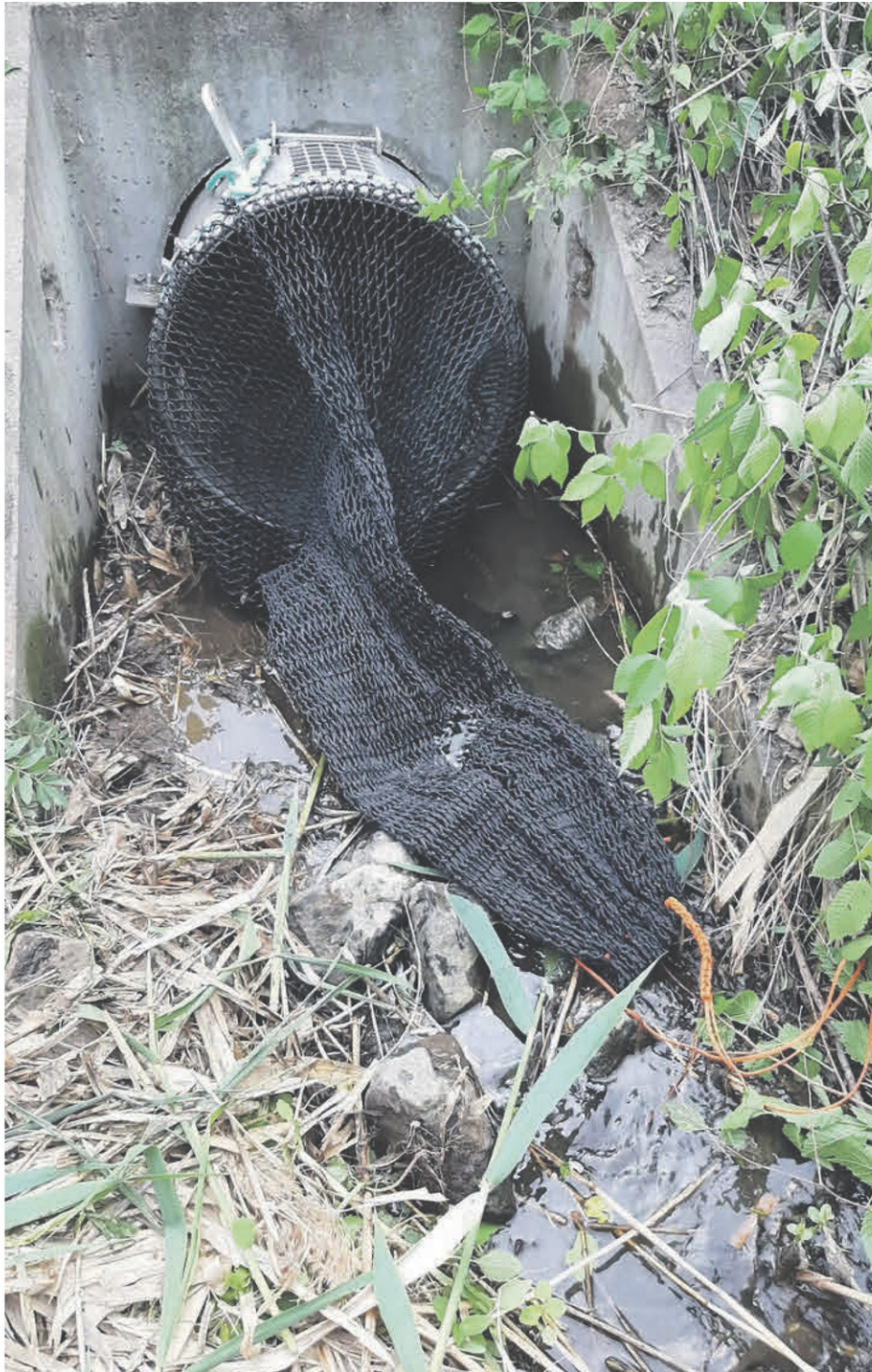
Quelques filets zéro déchet ont déjà été installés au bout d'exutoires en bordure de cours d'eau. Photo gracieuseté Nature Action Québec
